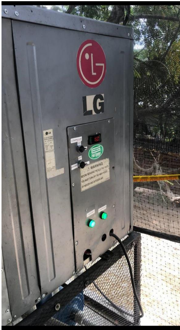
Fotografía 1. Chiller instalado en el galpón 9.
