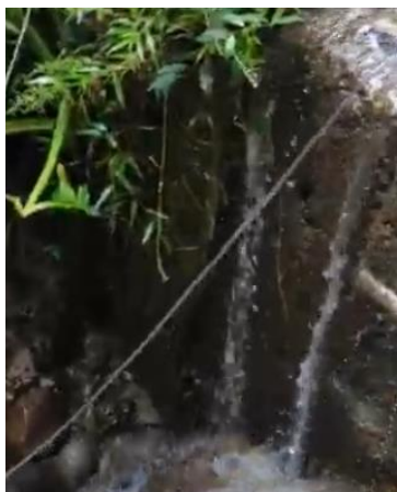
Imagen 10 Medición de presión en tubería - Extremo aguas arriba
