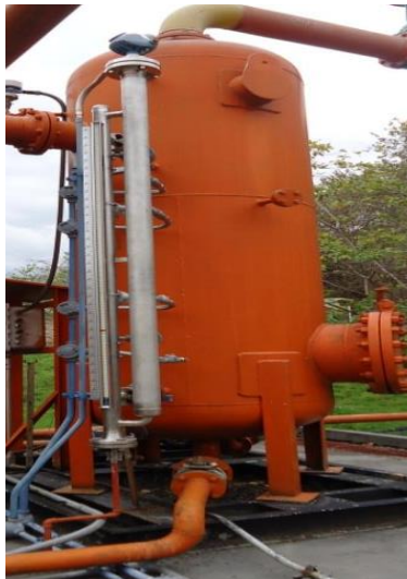
Ilustración 21: Separador de agua libre y condensado (Knock out drum)
