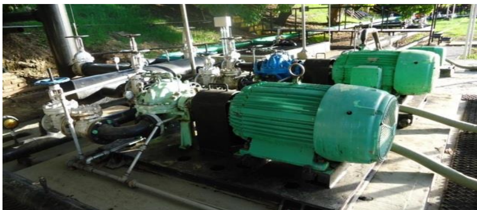
Ilustración 18: Bombas de transferencia de crudo
