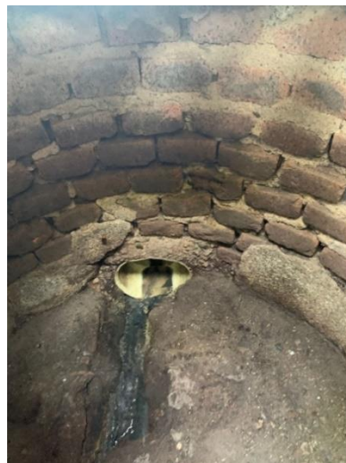
Figura 3-7: Visual interna de tubería y material existentes en el pozo.
