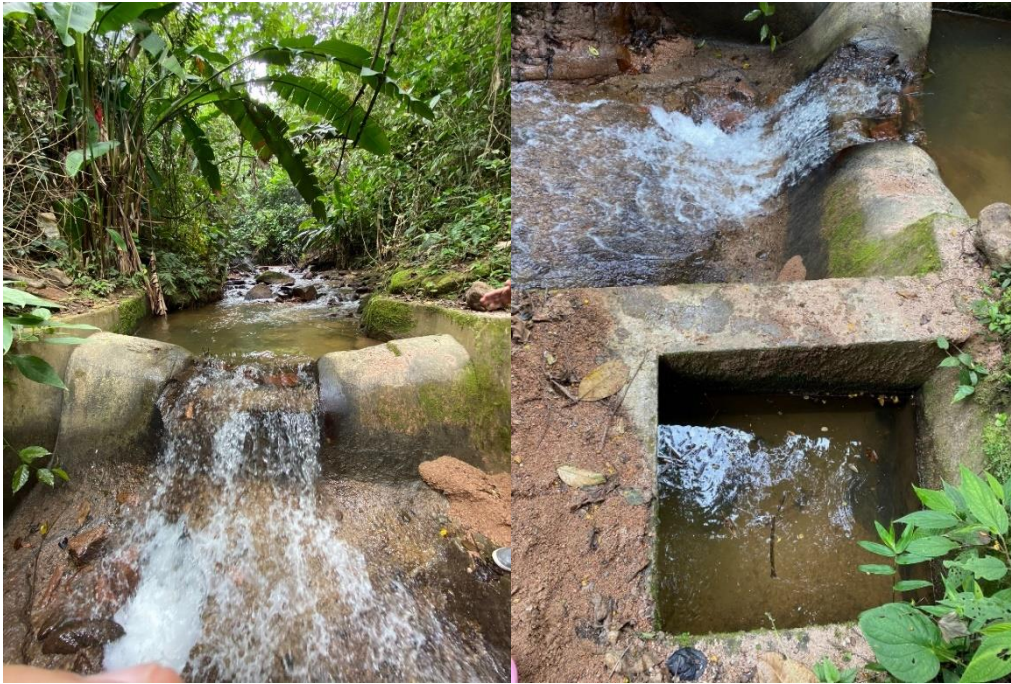
Figura 11. Estado actual de la bocatoma.
