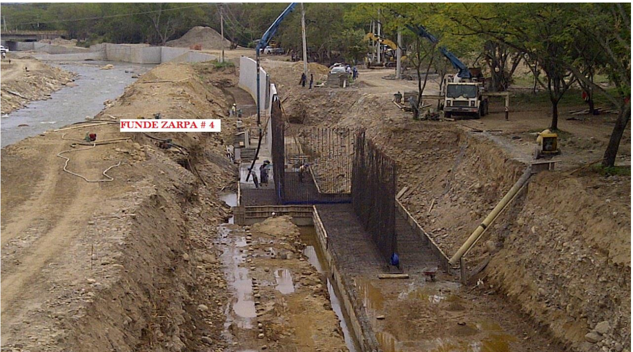
Ilustración 16: Funde zarpa margen derecha rampa acceso #4
