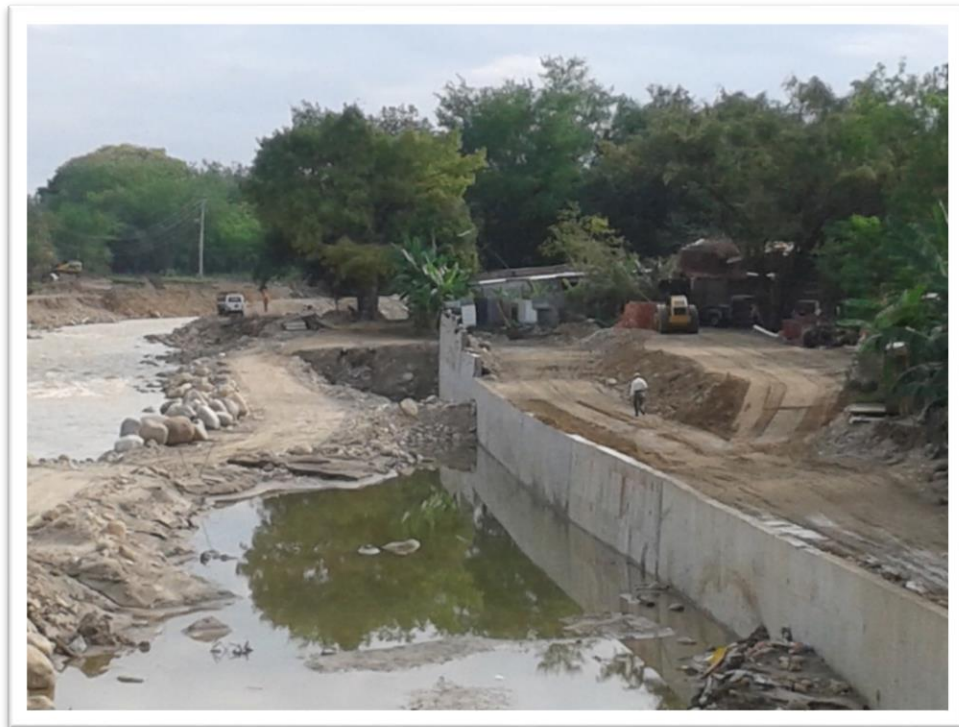
Muro lateral izquierdo con material de relleno
